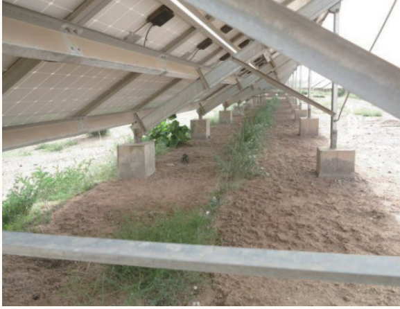
c 宁夏大唐青铜峡光伏电站
