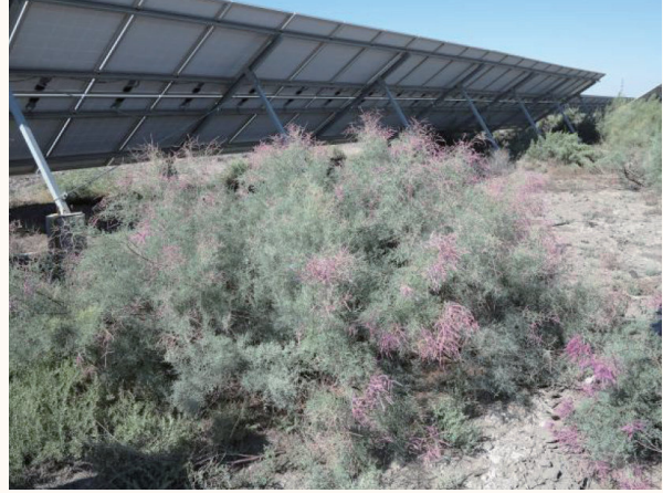
d 新疆五家渠荒漠盐碱地光伏电站
