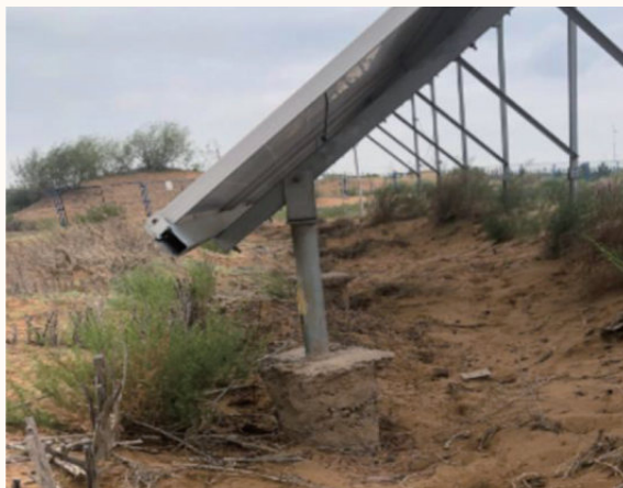
c 光伏板狭管效应造成桩基裸露
