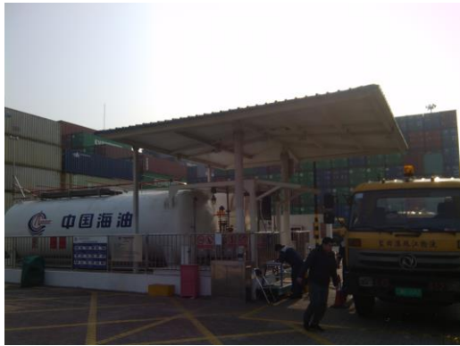
深圳盐田港区 LNG 撬装站
