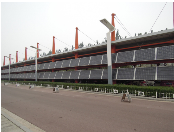
图 74 中新生态城园区光伏发电系统
