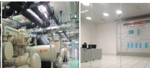
东部行政区能源站
