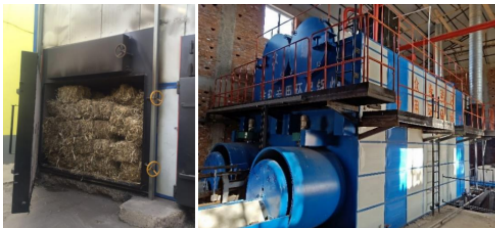
图 5-39 生物质打捆直燃供热系统
