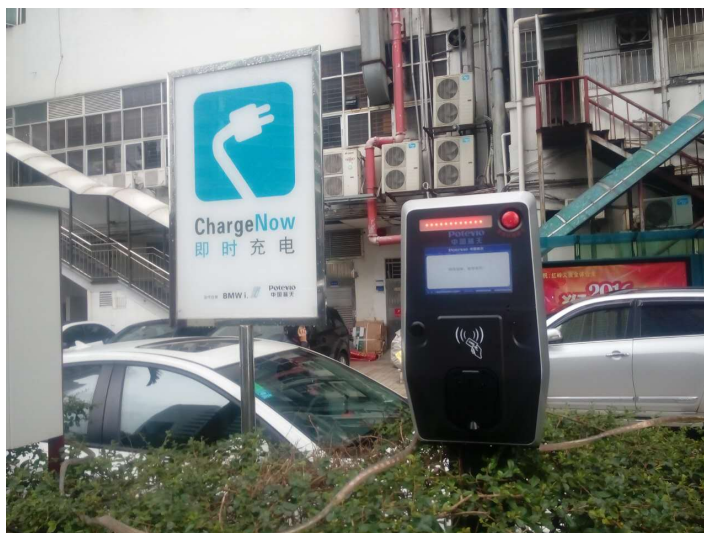
图 1-6 深圳某老旧小区花坛内安装的充电桩
