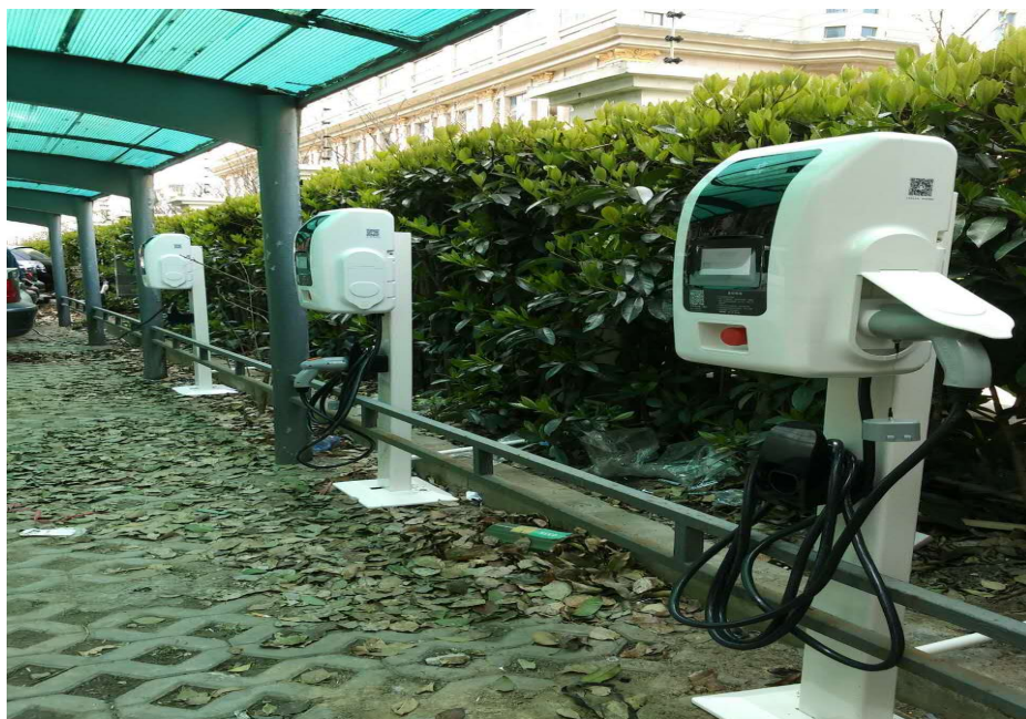
图 3-7 挚达公共充电桩现场图
