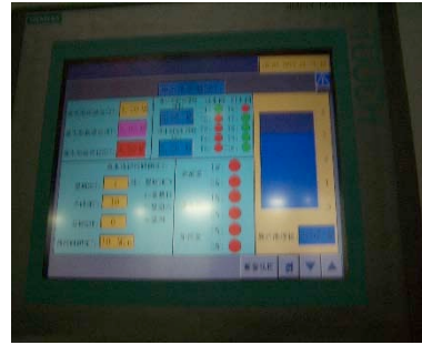
图 4-19 雨水处理池控制显示器
