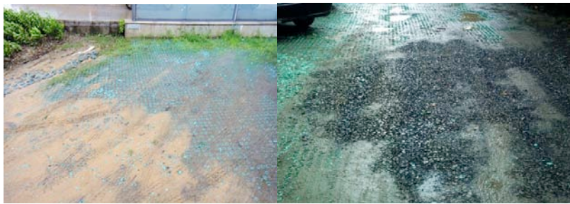
图 4-8 透水地面破坏严重
