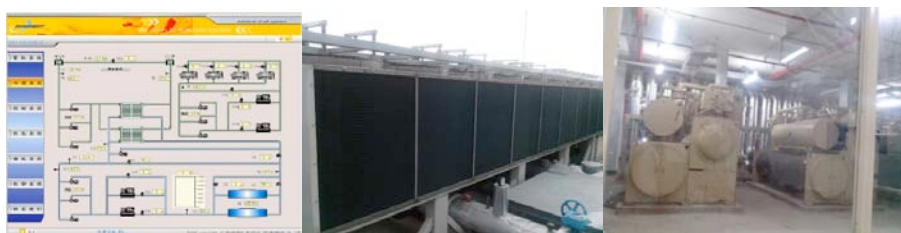
图 4-35 高性能集中热水机组及控制设备
